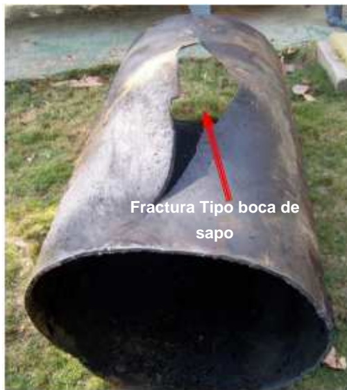
Foto N° 1: Fractura tipo boca de sapo.
